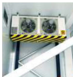
Control de Temperatura
