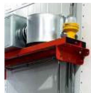
Sistema de Ventilación Forzada
