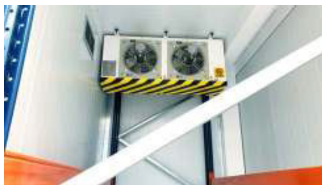
Sistema de Control de Temperatura Interior
